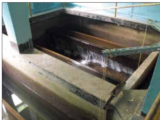
Istniejący filtr pośpieszny na stacji uzdatniania wody
