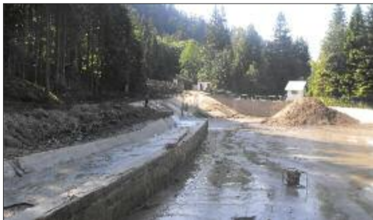
Osuszone ujęcie czekające na remont
